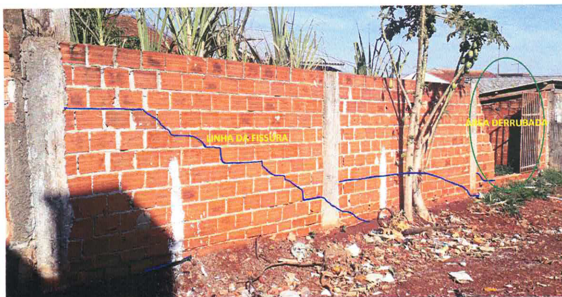
Foto 01: Vista Geral (Linha Fissuras / Área Demolida/Derrubada)
