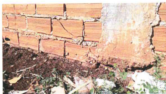
Foto 04: Fissura Coluna Direita
