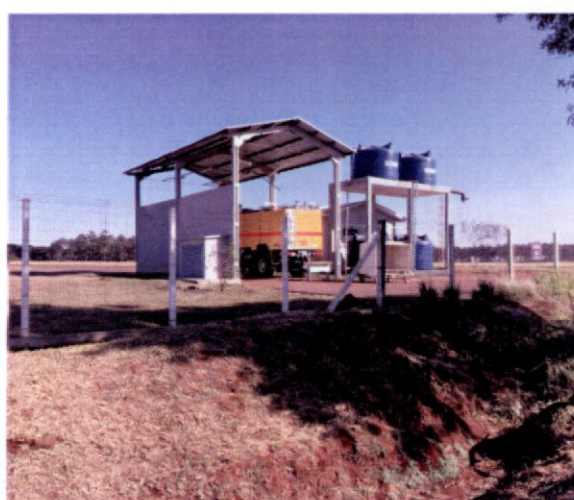
Seção Contra Incêndio - SCI
