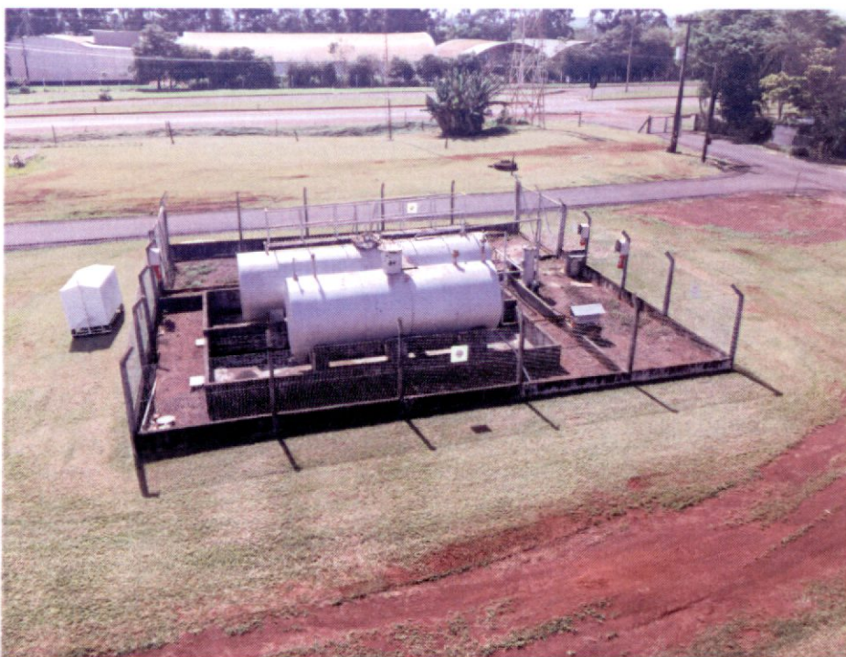
Posto de Armazenagem e Abastecimento – PAA Atual – JETA1 (Querosene) e AVGAS (Gasolina).
